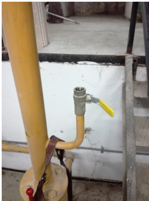
Slika 17. - Priključak za mjerni uređaj
