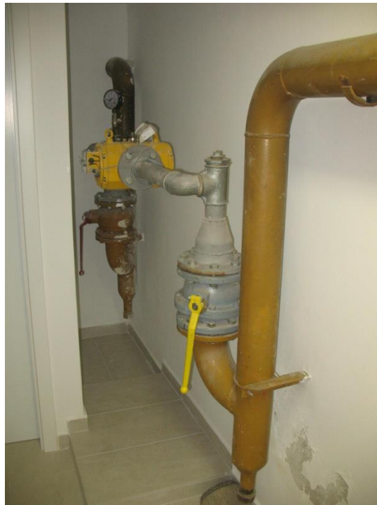
Slika 12. - Mjerna stanica plinske instalacije
