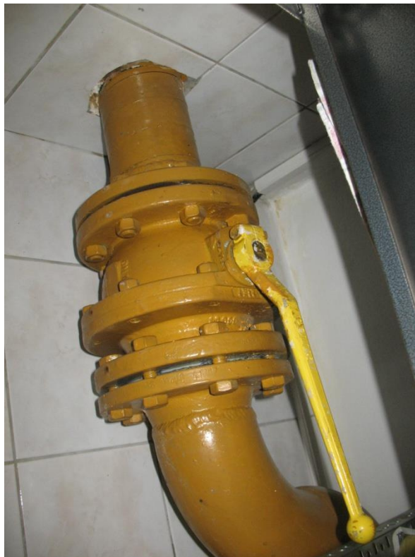
Slika 13. - Glavni zaporni ventil plinske instalacije
