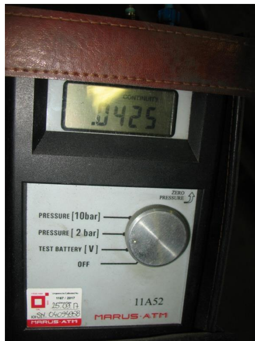
Slika 23. - Trenutna vrijednost tlaka u instalaciji
