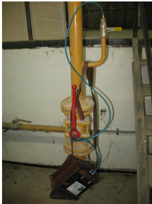
Slika 21. - Digitalni mjerni uređaj spojen na instalaciju
