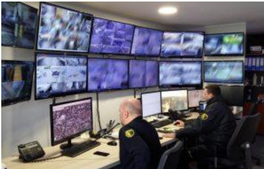
Slika 19. Predodžba centralnog dojavnog sustava
