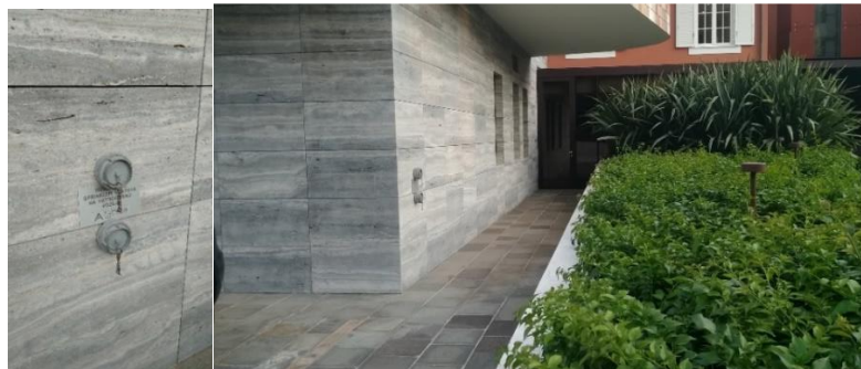
Slika 28. Priključak na objektu za vatrogasno vozilo pored glavnog ulaza u objekt [10]
