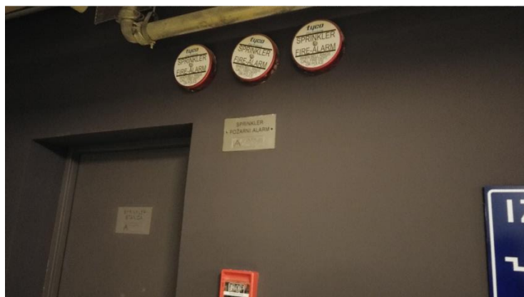
Slika 34. Hidraulična alarmna zvona i sirena [10]
