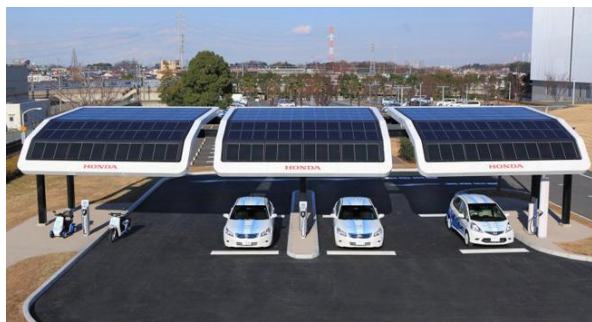
Slika 27. Primjer stanice za punjenje elektroauta pomoću solarnih ćelija
