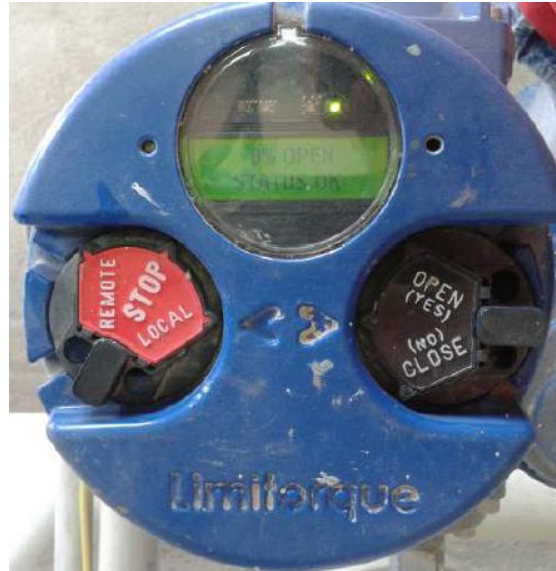
Sl. 26. Upravljačke komande ventila [vlastita fotografija]
