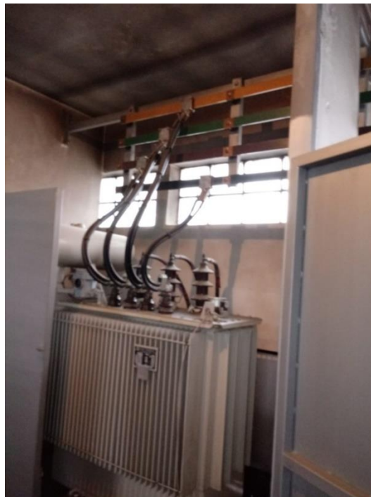
Slika 25. Predodžba niskonaponske spojnice-letve (gornji dio slike).
