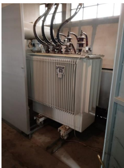
Slika 23. Predodžba transformatora, rebara hladnjaka i naponskih priključnica.
