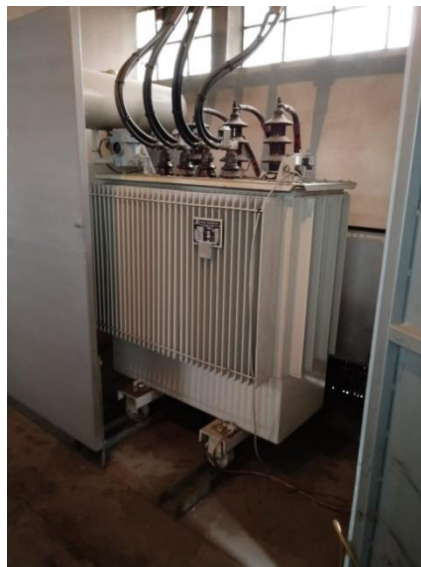
Slika 23. Predodžba transformatora, rebara hladnjaka i naponskih priključnica.
