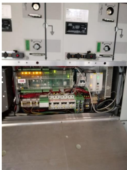
Slika 31. Predodžba unutrašnjost ABB sredjenaponskog bloka s kontrolerom.
