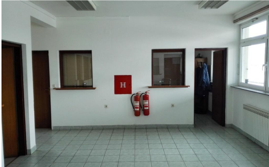
Slika 26. Hidrantski ormarić broj 1 (prostorija 3) zgrade
