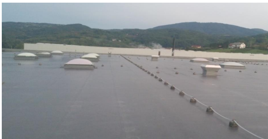
Slika 20. Sustav obrane od udara groma na krovu pogona
