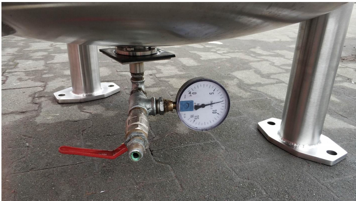
Slika 38. Prikaz manometra na totalnom ispustu
