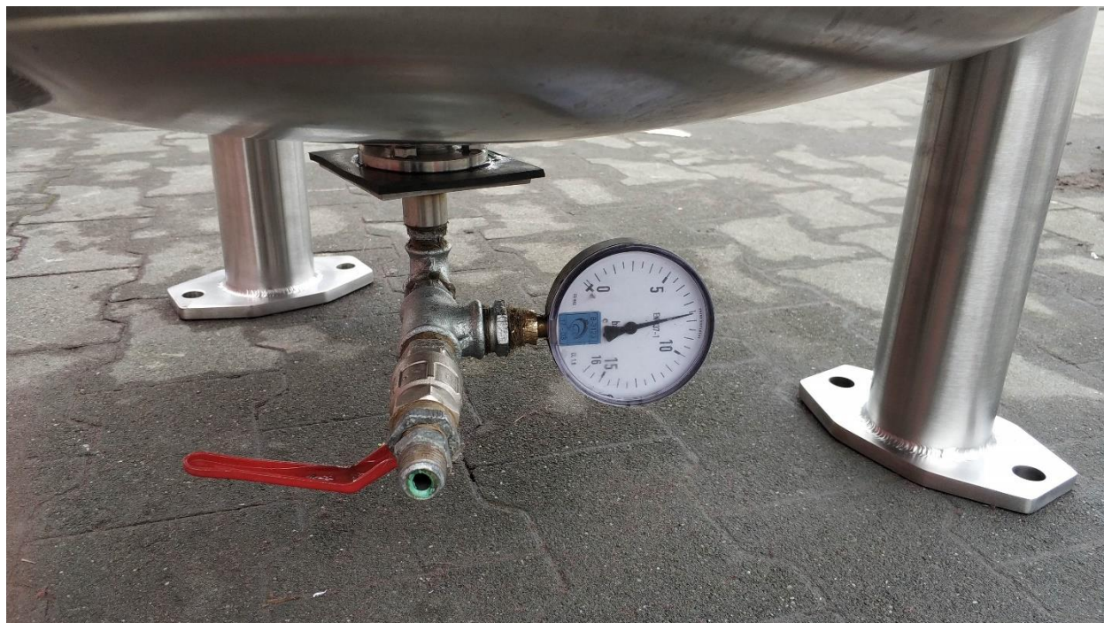
Slika 38. Prikaz manometra na totalnom ispustu
