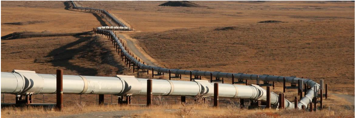
Slika 5. Primjer transportnog cjevovoda [7]
