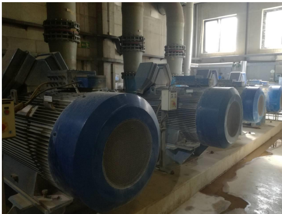
Slika 26. Motori pumpa suspenzije vapnenca: snage 355 kW i 315 kW (ovisno na koju visinu pumpaju).
