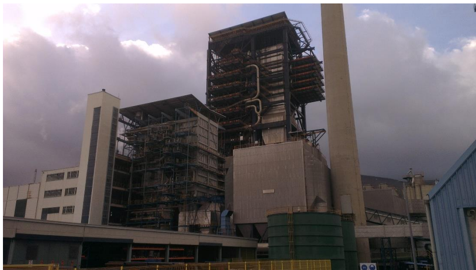
Slika 3. Prikaz postrojenja TE Plomin 1 i 2.
