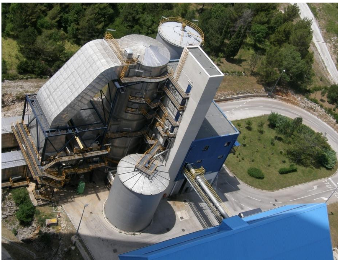
Slika 24. Postrojenje za odsumporavanje dimnih plinova, REA.
