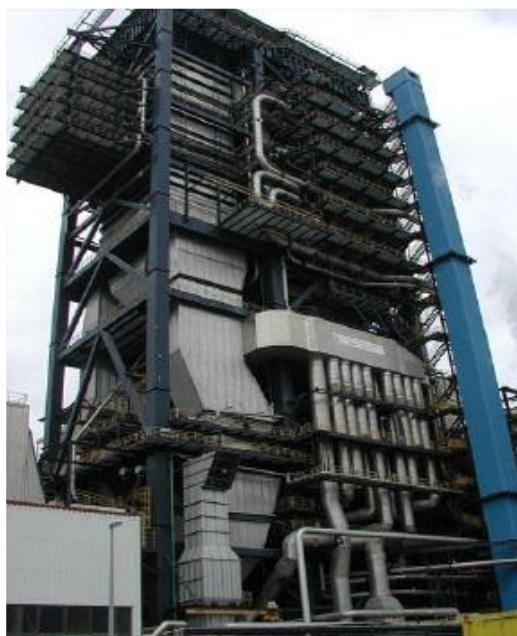
Slika 13. Kotlovsko postrojenje TE Plomin 2. [17]
