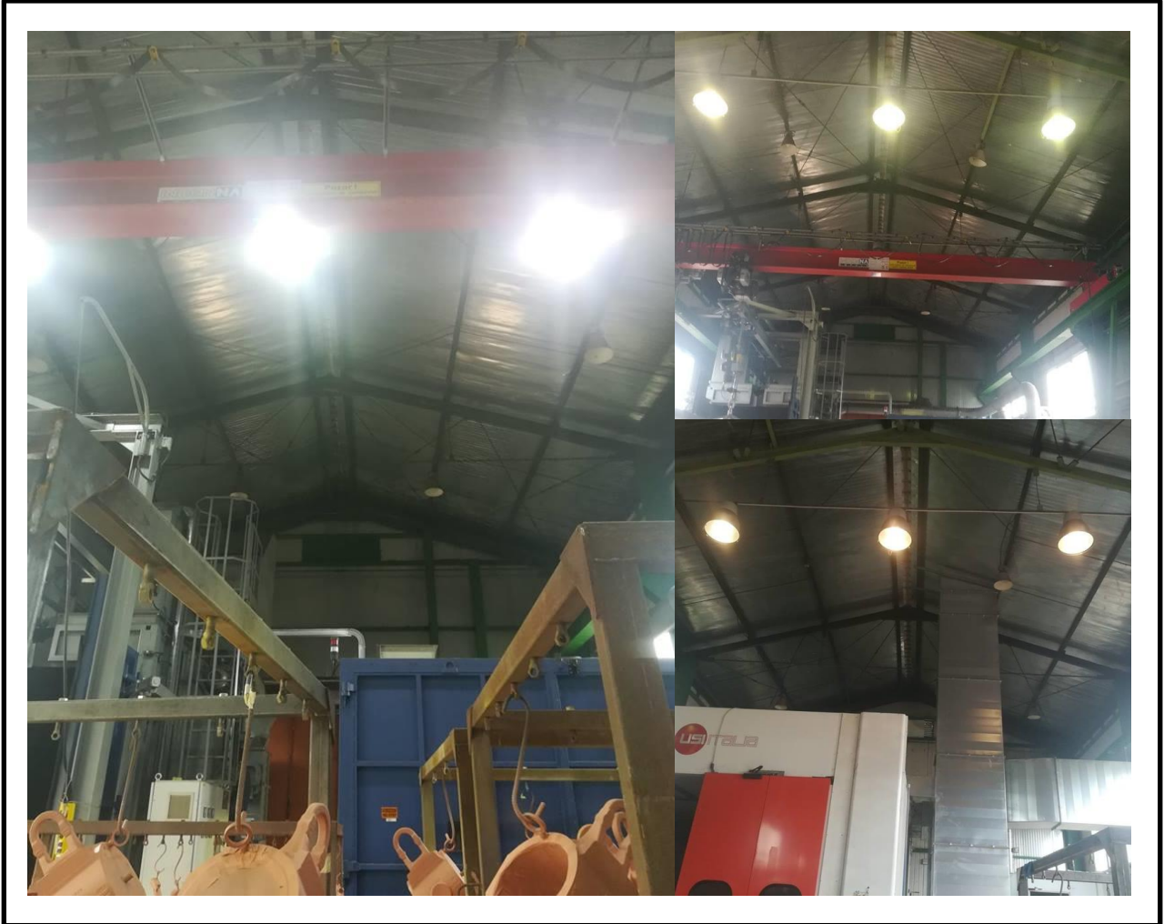
Slika 21: Pogon lakirnice i antikorozivne zaštite
