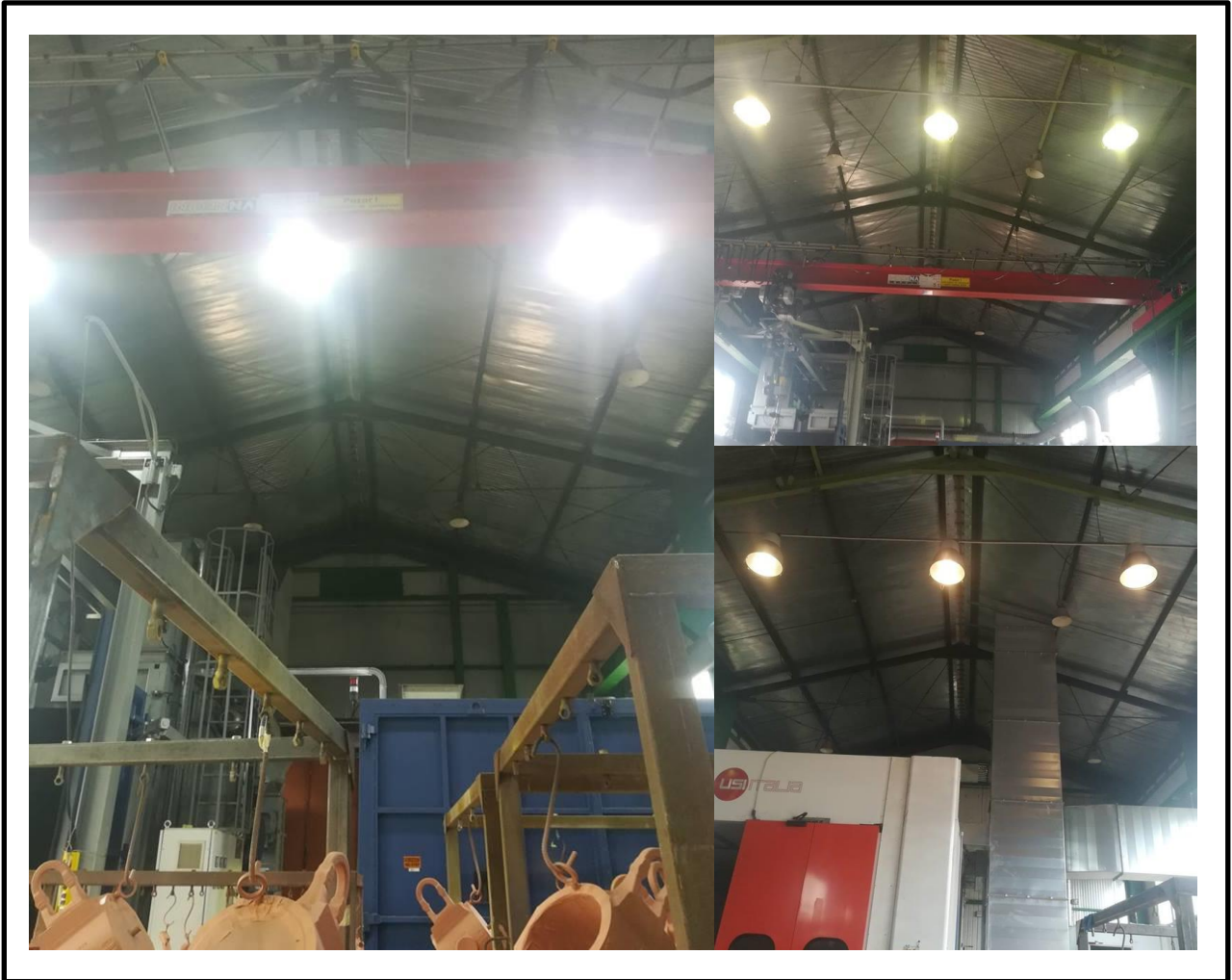
Slika 21: Pogon lakirnice i antikorozivne zaštite
