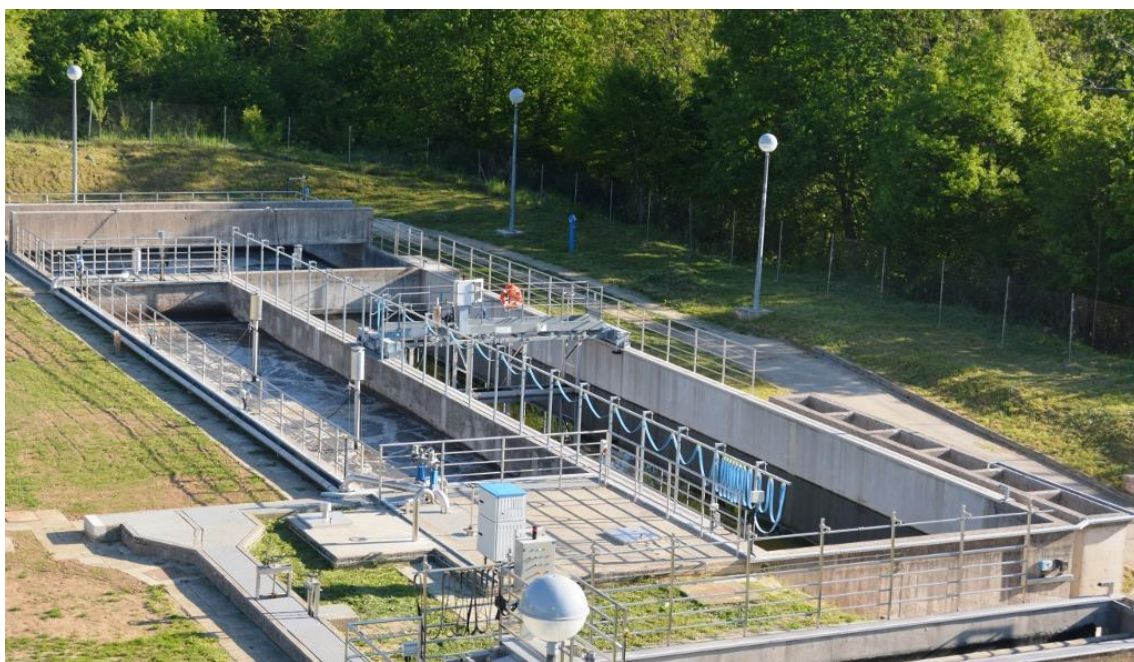
Slika 6. Uređaj za pročišćavanje otpadnih voda
