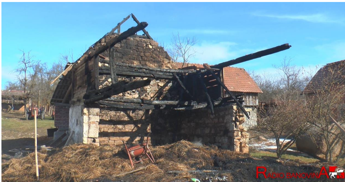
Slika 14. Prikaz opožarenog gospodarskog objekta štale.[26]
