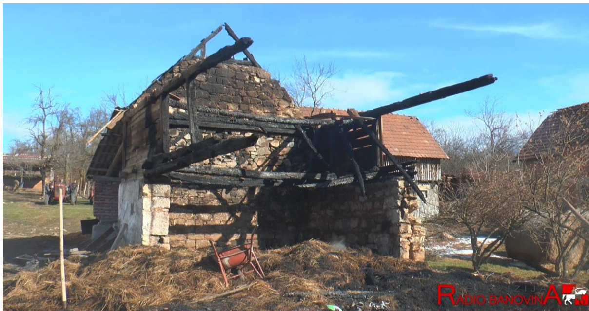
Slika 14. Prikaz opožarenog gospodarskog objekta štale.[26]
