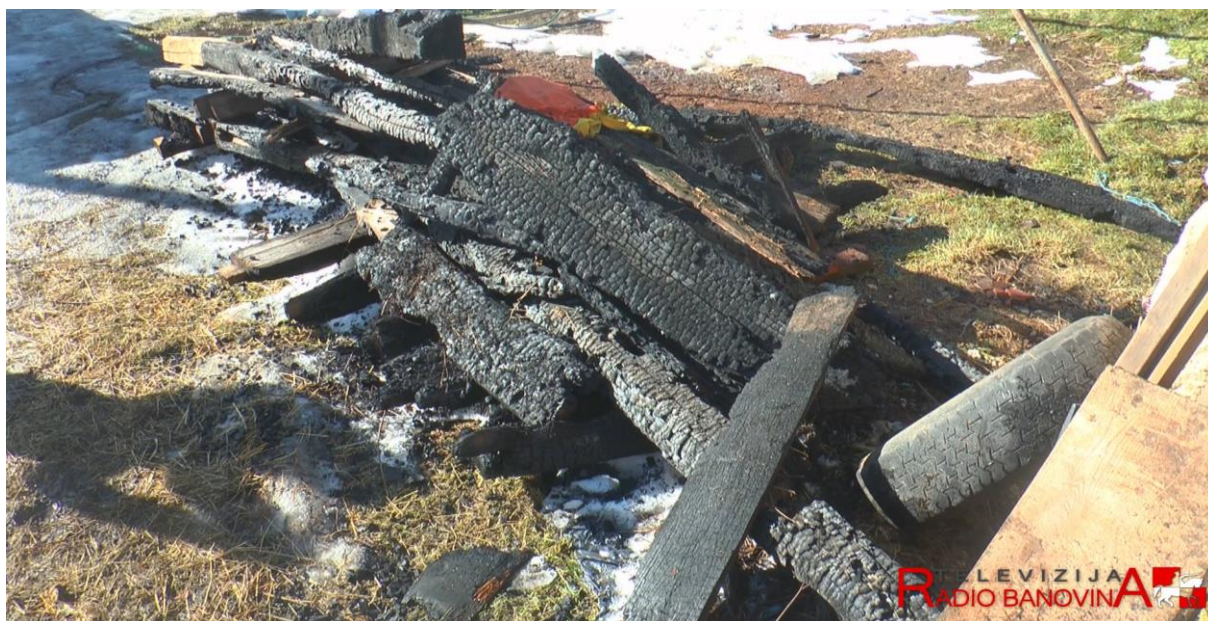
Slika 15. Izgorjela drvena građa s gospodarskog objekta štale.[26]
