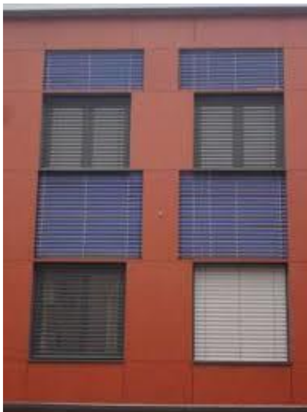
3.12. Vakuumski kolektori na fasadi objekta, Špansko – Zagreb [1]
