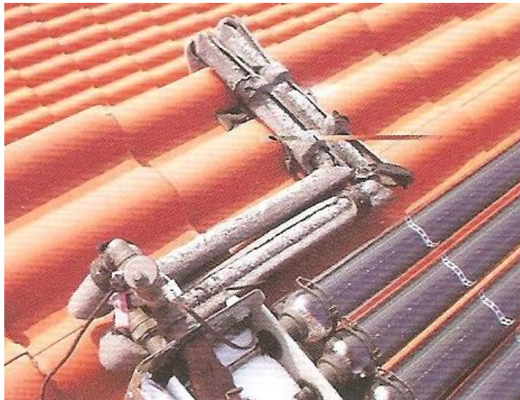
Slika 6.4. Izolirane cijevi običnom izolacijom [1]
