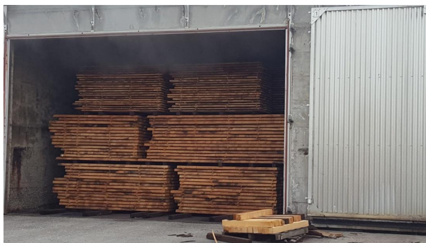
Slika 26. Sušara drvene piljene građe [26]
