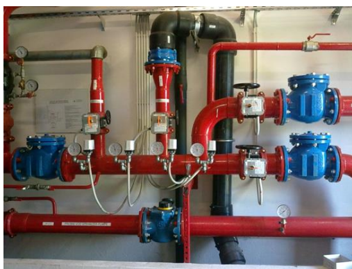
Slika 26. Cijevi sprinkler sustavi [14]
