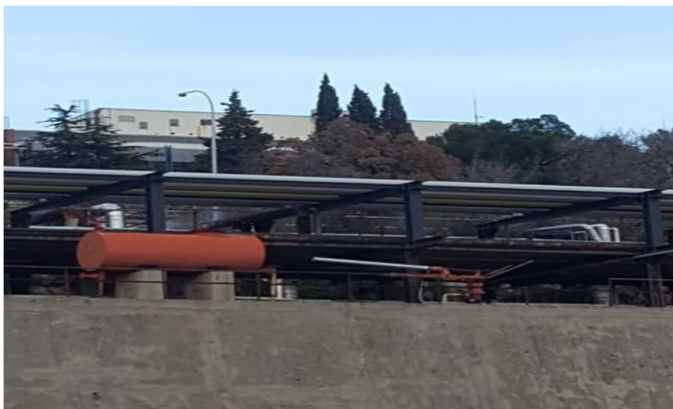
Sl. 7. Bacač voda/pjena sa pripadajućim spremnikom pjenila
