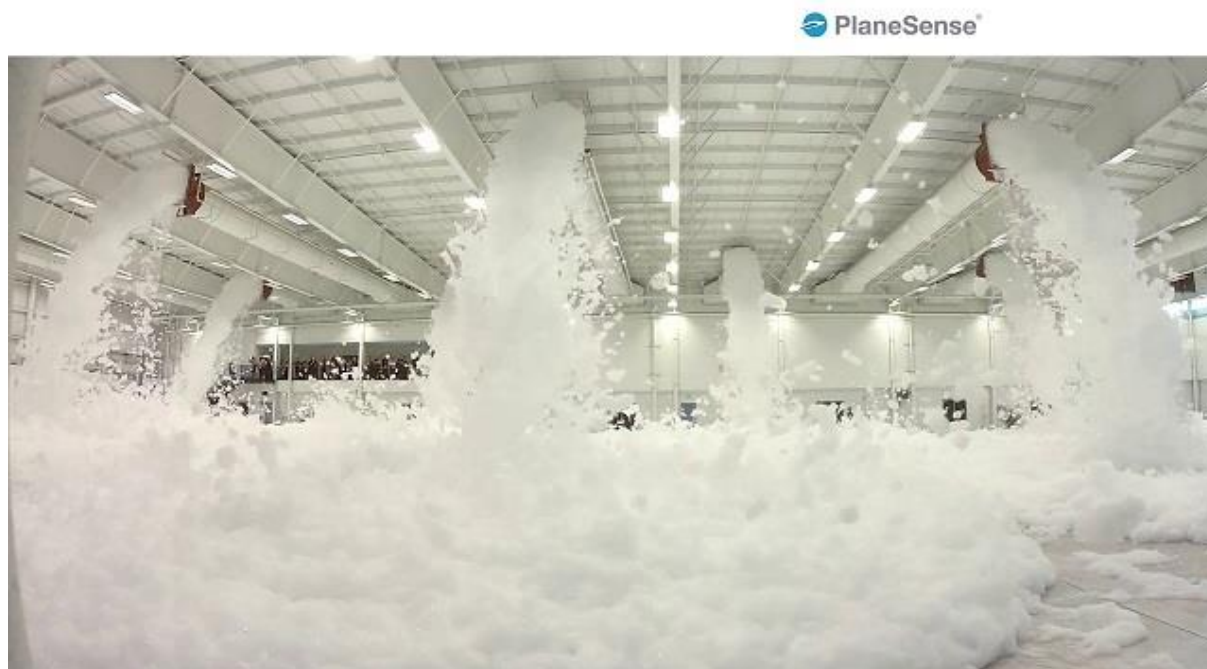
Sl. 21. Stabilni sustav za gašenje lakom pjenom [17]
