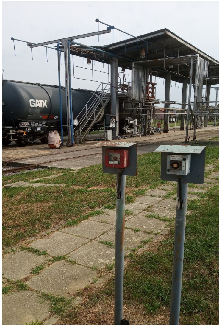
Slika 30. Drencher stabilni sustav na vagon pretakalištu i tipkala za aktivaciju sustava [14]
