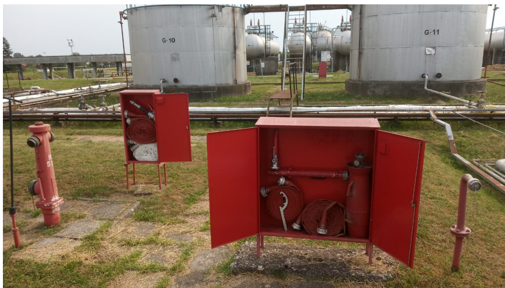
Slika 7. Hidranti i hidrantski ormarići [14]
