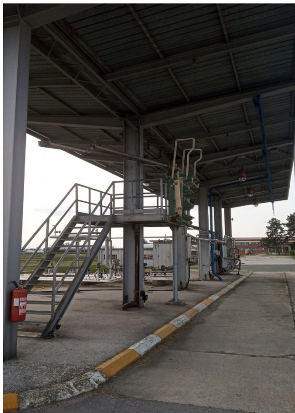
Slika 19. Vatrogasni aparat za početno gašenje požara [14]
