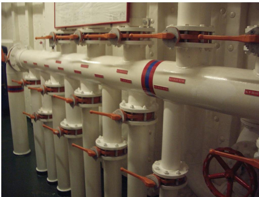
Slika 21. Ventili sustava drencher [17]
