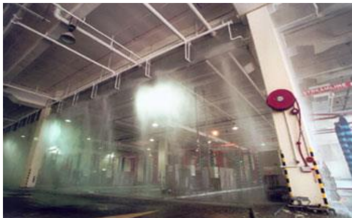
Slika 13. Sustav za prskanje vode pod tlakom [14]
