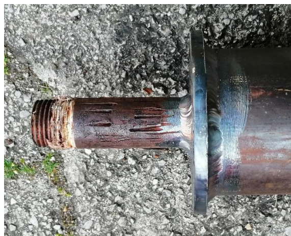
Slika 44. Zavareni spoj grane za punjenje
