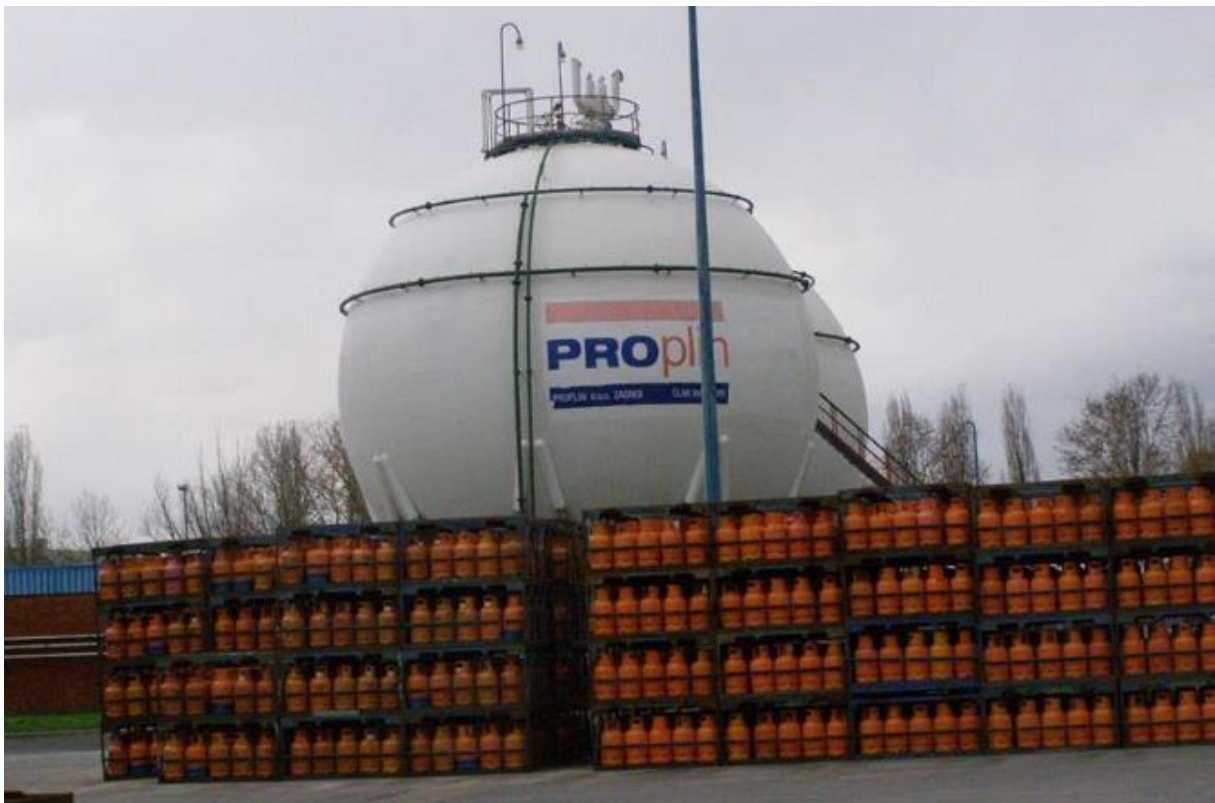
Slika 3. Sferni spremnik u krugu postrojenja [2]
