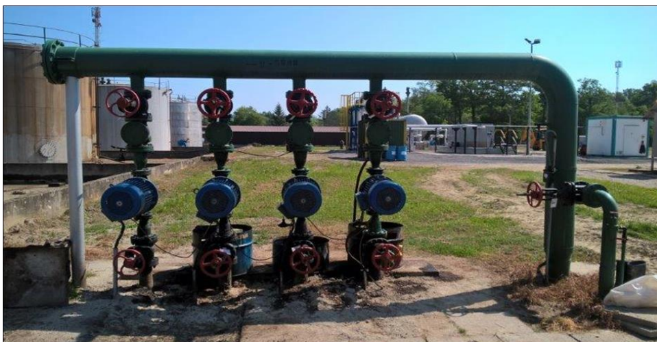
Slika 9. Procesna pumpona suhe nafte [2]
