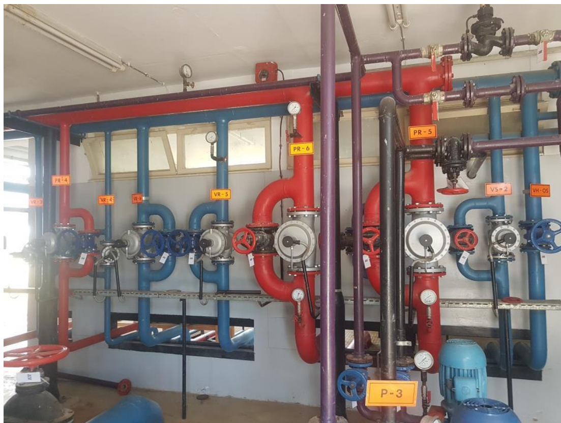
Slika 41. Instalacije u vatrogasnici
