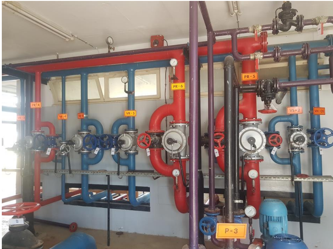
Slika 41. Instalacije u vatrogasnici
