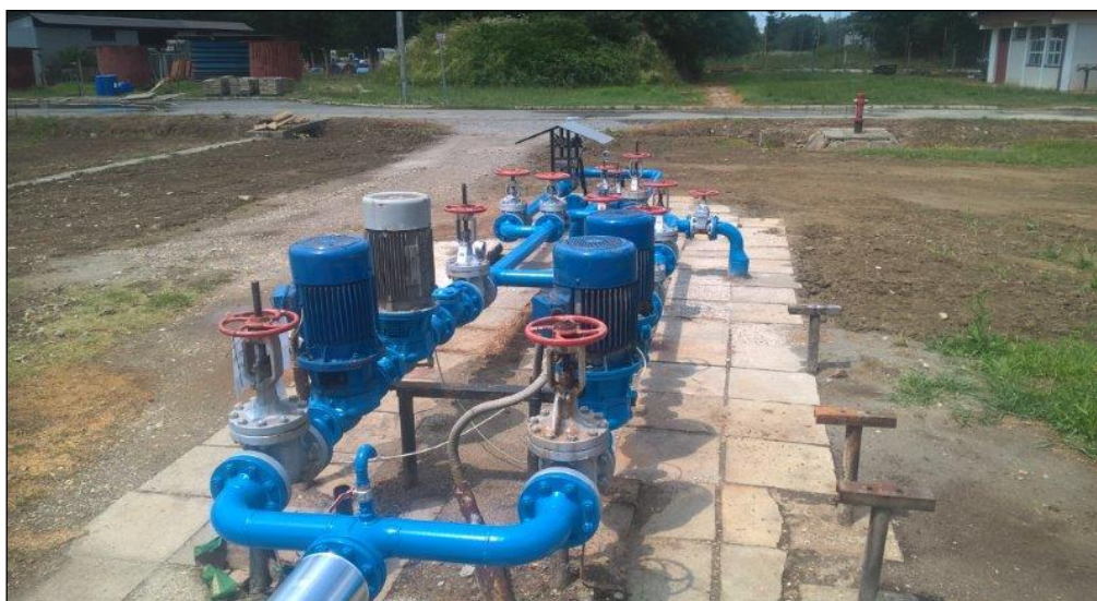
Slika 13. Pumpaona slane vode [2]
