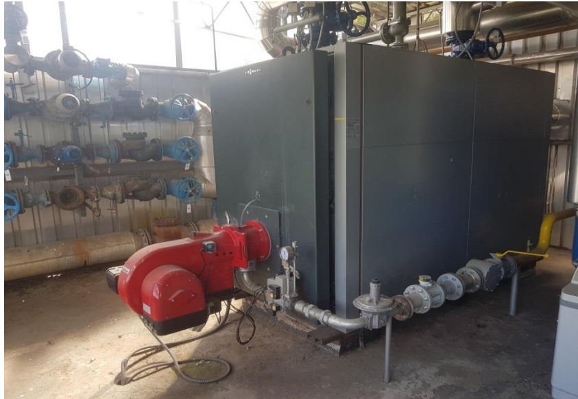
Slika 27. Regulator tlaka u kotlovnici
