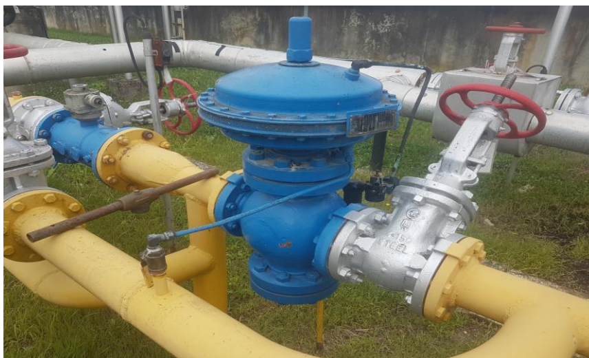
Slika 26. Običan regulator na plinskoj rampi
