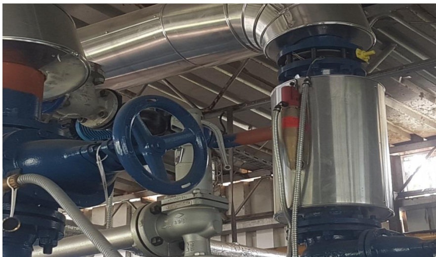
Slika 28. Sigurnosni ventil u kotlovnici
