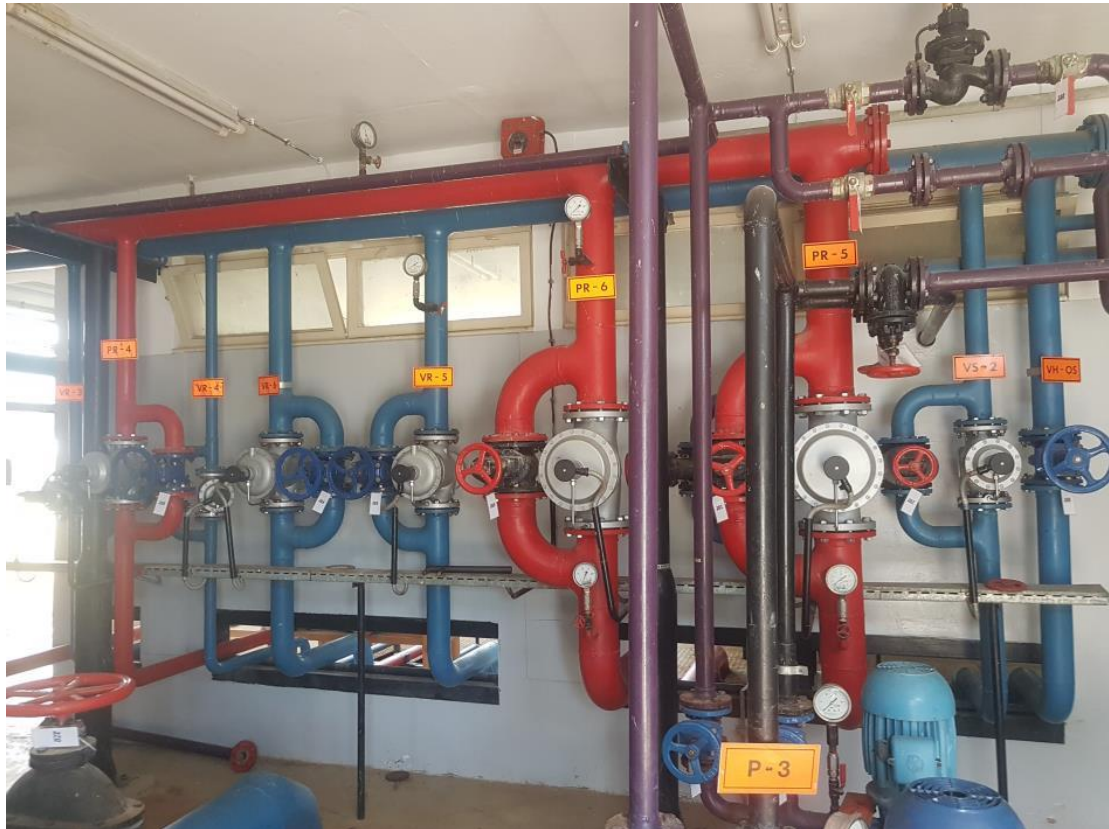
Slika 41. Instalacije u vatrogasnici
