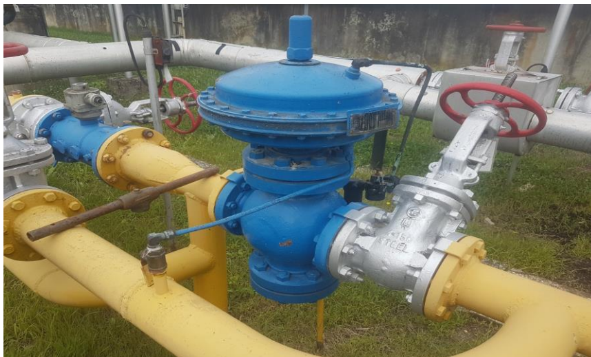
Slika 26. Običan regulator na plinskoj rampi
