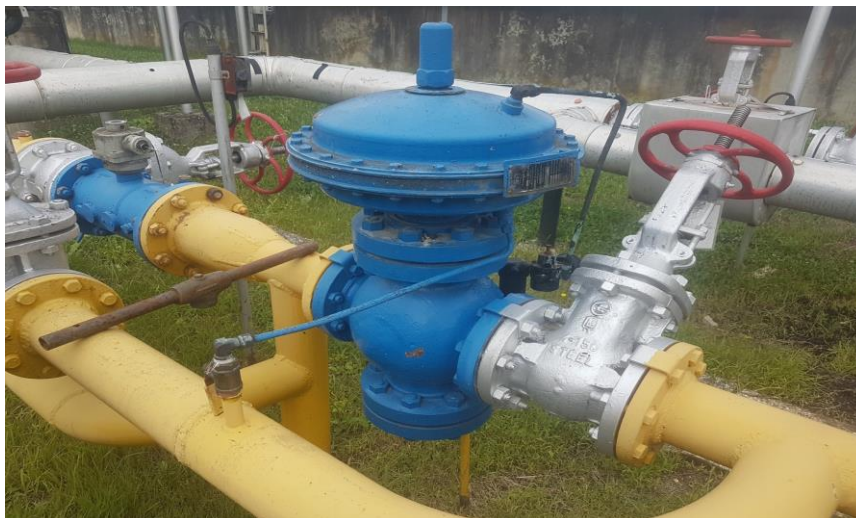
Slika 26. Običan regulator na plinskoj rampi
