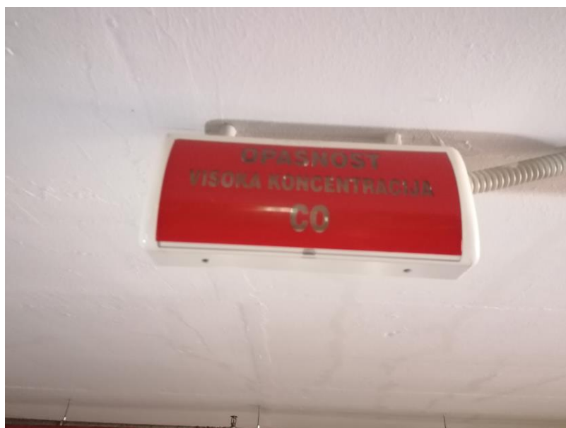
Sl. 21. Svjetlosna signalizacija opasnosti visoke koncentracije CO [24]
