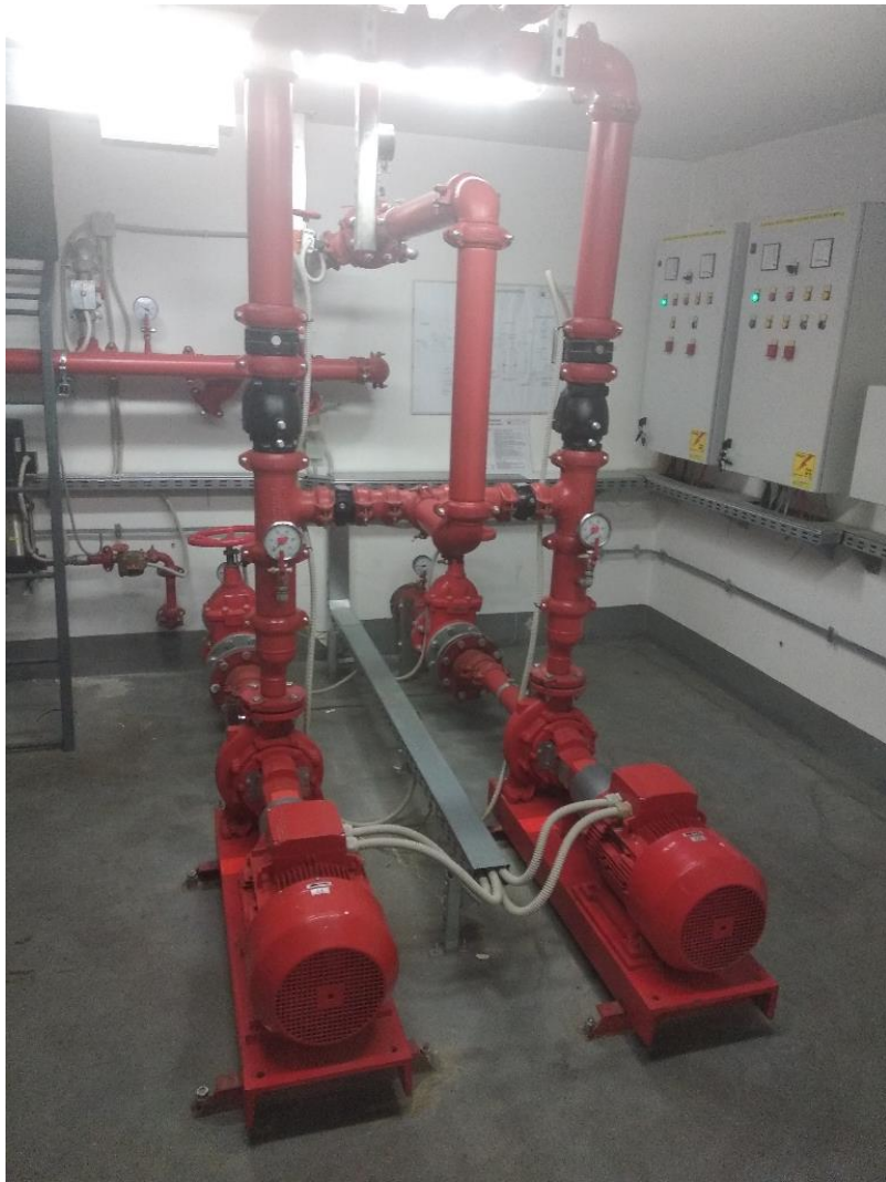
Sl. 12. Cjevovodi sprinklerske stanice [16]
