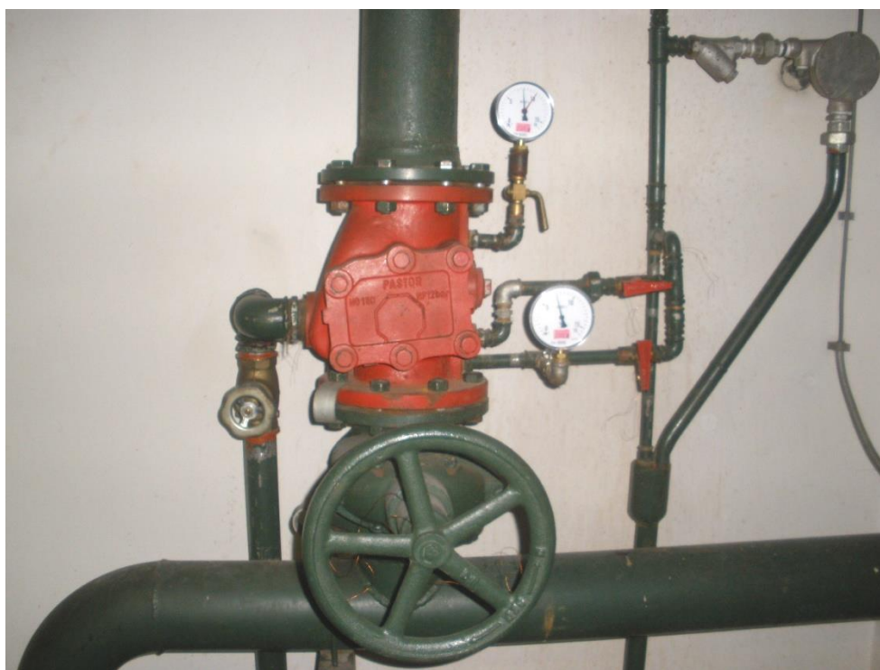
Slika 6. Mokri sprinkler ventil u stanici ( vlastiti izvor )
