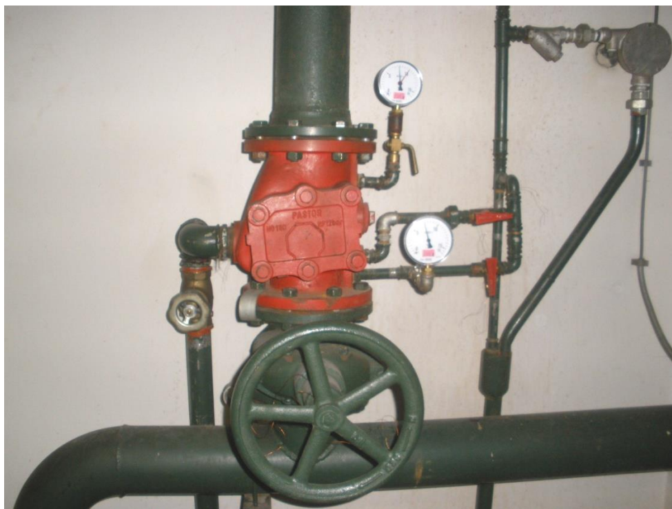
Slika 6. Mokri sprinkler ventil u stanici ( vlastiti izvor )
