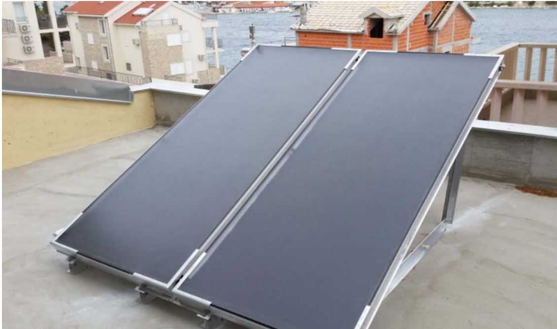
Slika 21. Pločasti solarni kolektori (instalacija na krovu obiteljske kuće) [autor]
