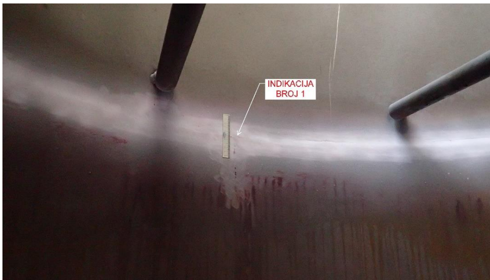
Slika 45. Položaj indikacije broj 1 na kružnom tehnološkom zavaru plašta. [2]
