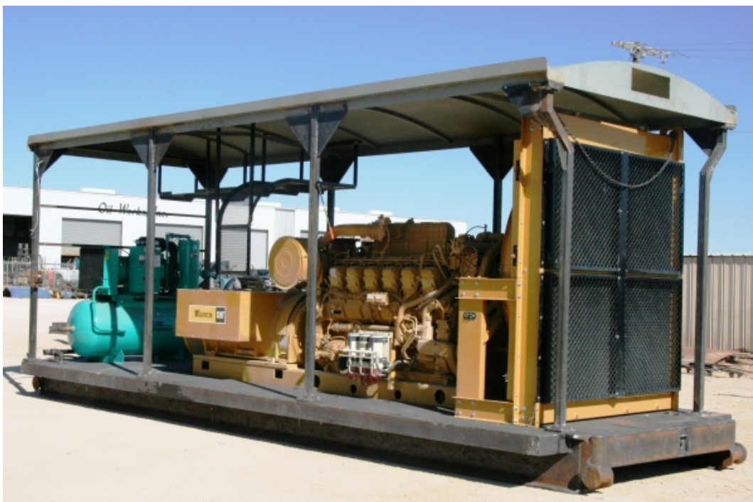
Slika 14. Tipičan izgled generatora na bušačem postrojenju
