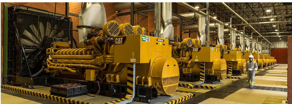
Slika 15. Izgled paralelno spojenih generatora u potpalublju platforme
