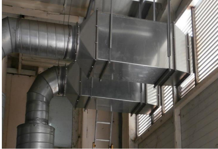
Slika 7. Prigušivači buke u ventilacijskom sustavu
