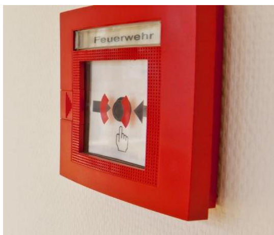
Slika 27. Sustav za dojavu požara [38]
