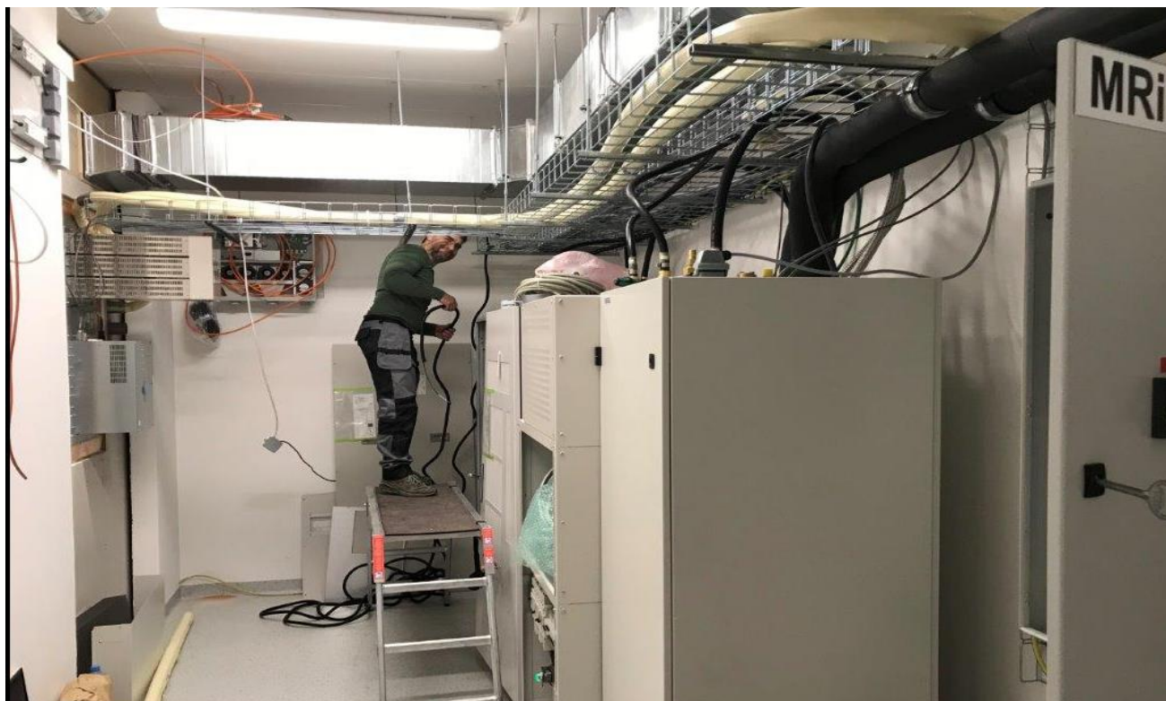
Slika 6. Predodžba ormara s elektronikom u tehničkoj sobi. Izvorno autor.
