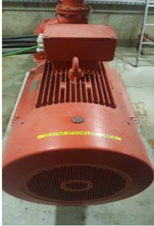
Sl. 9. Glavna sprinkler pumpa [19]
