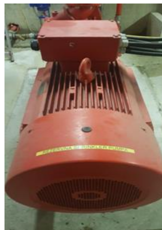
Sl. 10. Rezervna sprinkler pumpa [19]
