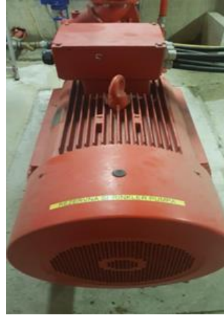
Sl. 10. Rezervna sprinkler pumpa [19]
