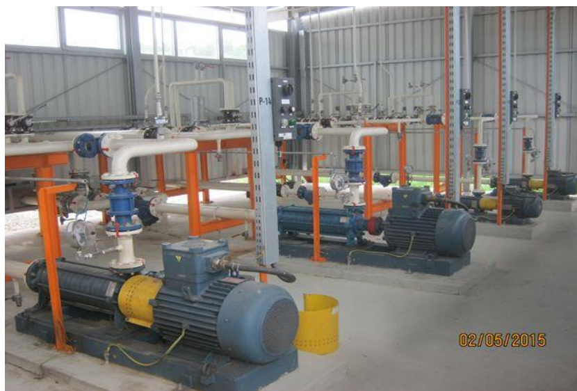
Slika 8. Pumpe i kompresori u PS1
