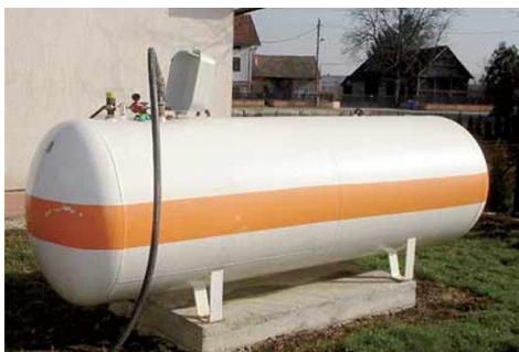
Slika 1. Stabilni plinski spremnik
