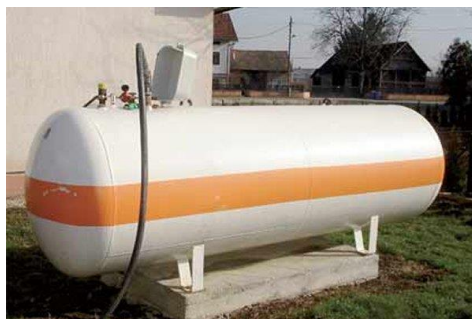
Slika 1. Stabilni plinski spremnik
