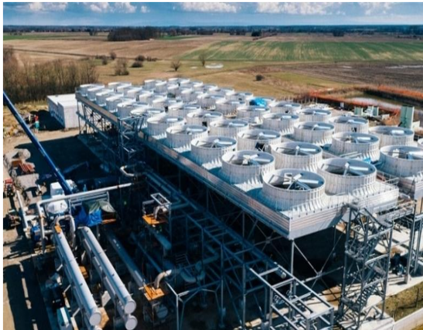
Slika 16. Geotermalna elektrana Velika 1 [24]
