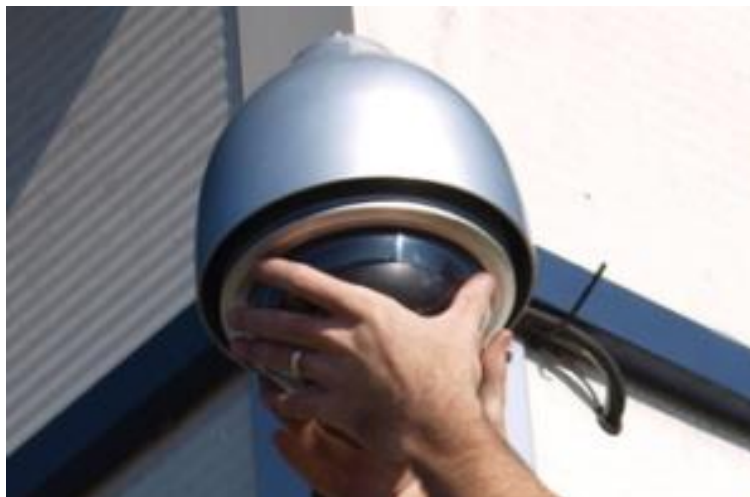
Slika 13. Predodžba postavljanja vanjske kamere: Izvor http://protuprovala.hr/video-nadzor/
