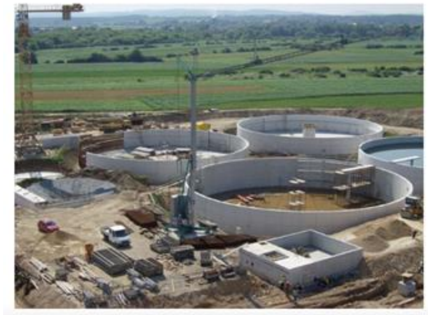
Slika 1. Uređaj za pročišćavanje otpadnih voda [6]
