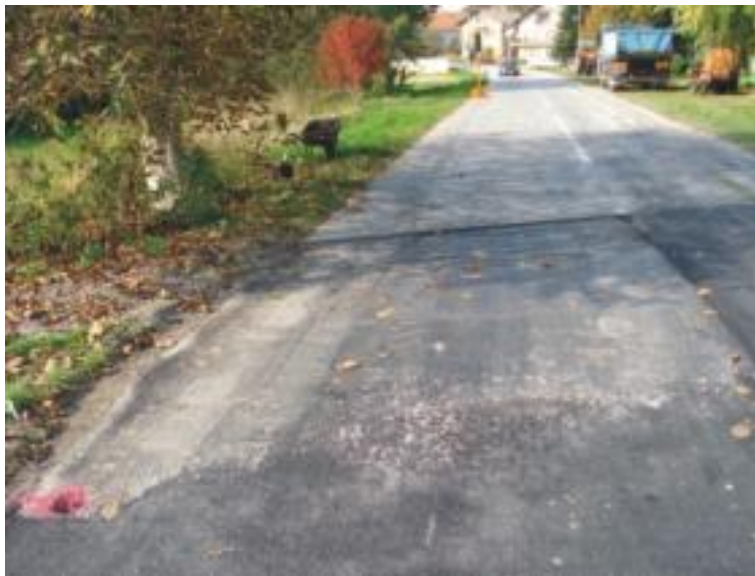
Slika 8. Neravnine i izbočine po cestama često su posljedica vibracija
