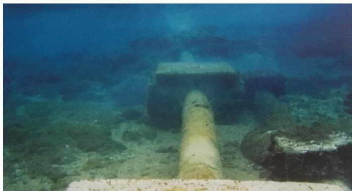
Slika 3. Podvodni ispušt (Tušar, 2009.)
