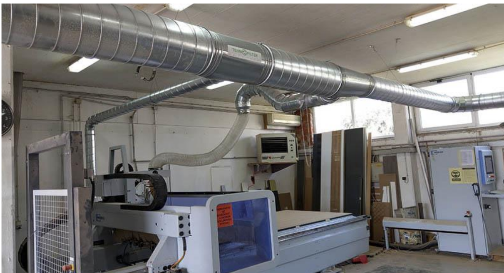
Slika 18: Ventilacijski cjevovod unutar pogona
