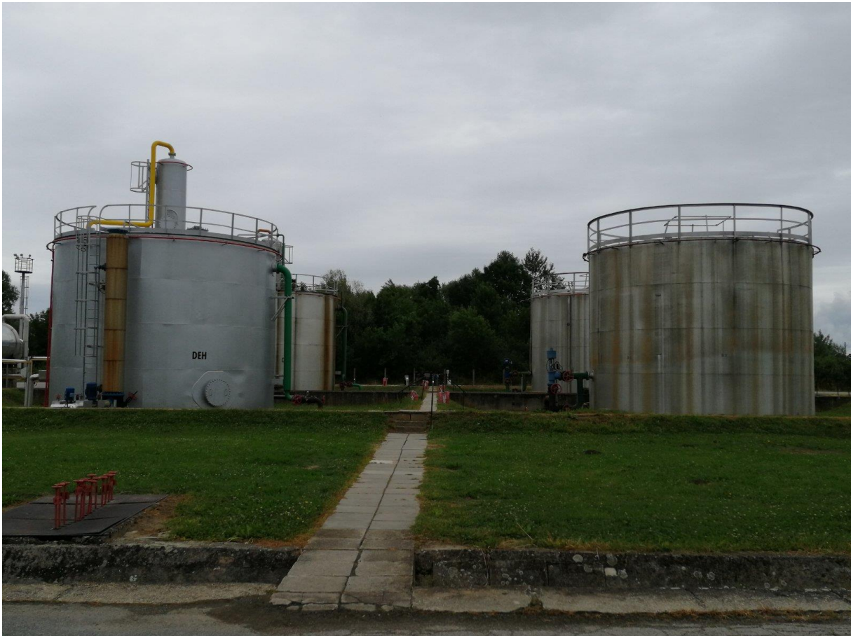
Slika 3. Spremnici nafte (desno) , dehidrator (lijevo) [19]
