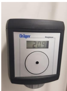
Slika 16. Mjerač koncentracije kisika u prostoru dio je sustava alarmiranja niske koncentracije
