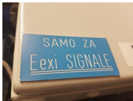
Slika 23. Oznaka na elektroormaru u kojem se nalaze pex uređaji
