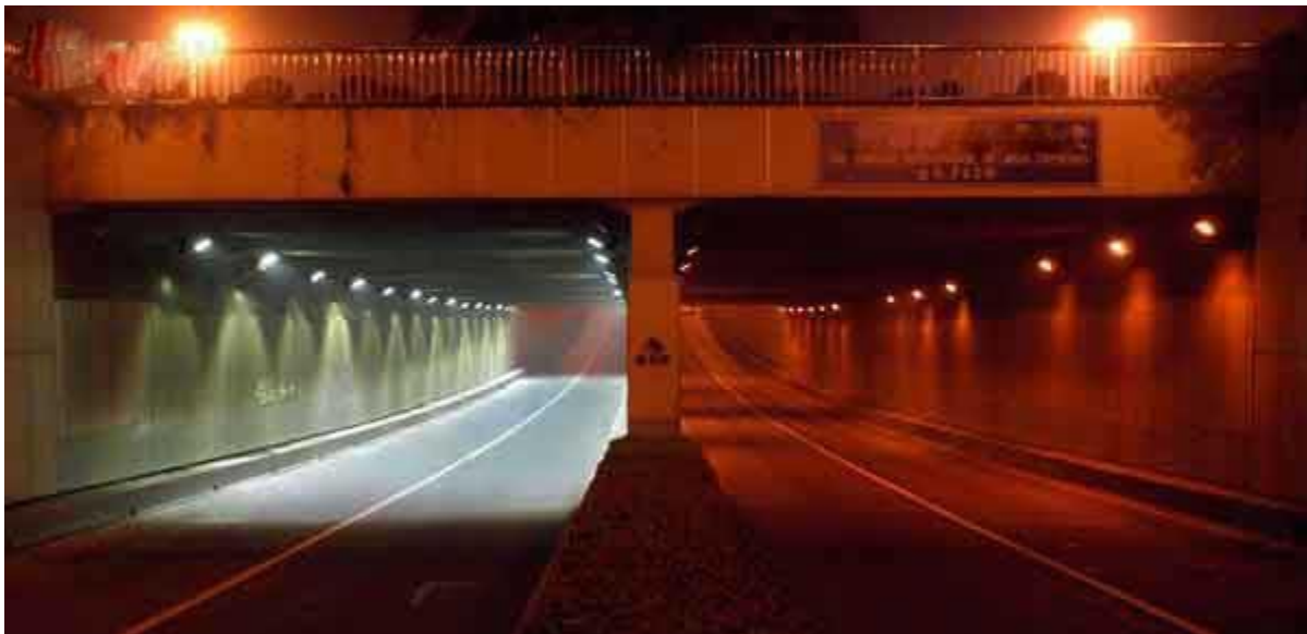
Slika 12. Rasvjeta u tunelu
