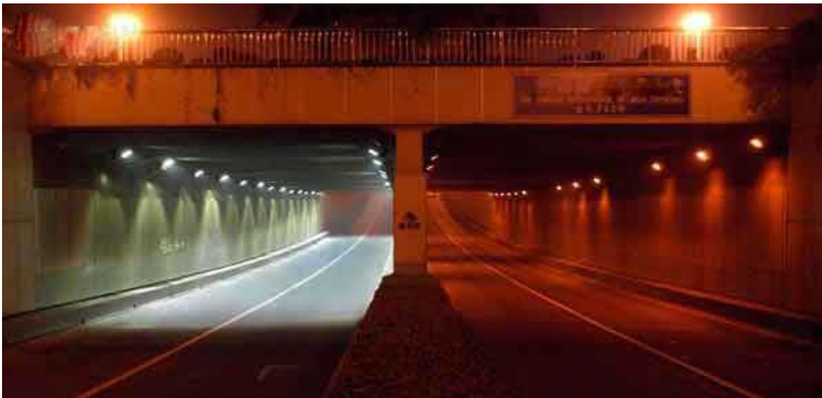
Slika 12. Rasvjeta u tunelu
